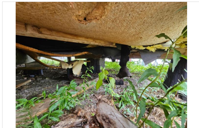
Hull i gulv under bad, fremkommer synlig avløpsrør her, stubbplater løsnet flere steder under stue.
