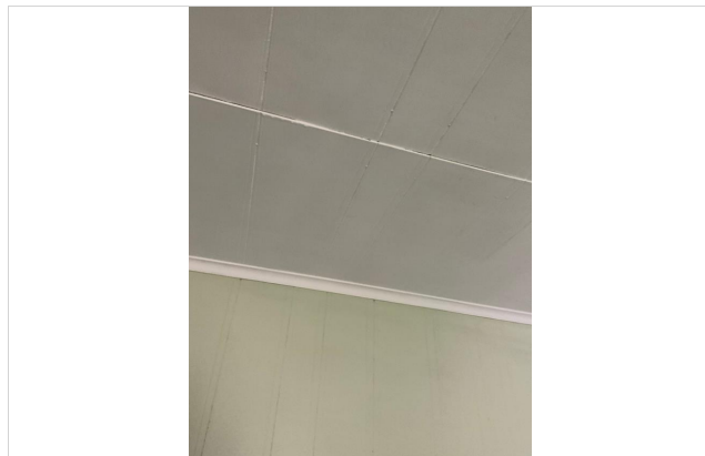
Takplater på soverom har løsnet fra innfestning.
