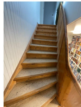
trapp 1 etasje mangler håndløper på vegg.
