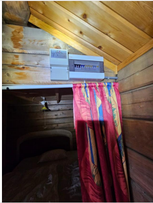
El-anlegg med automatsikringer
