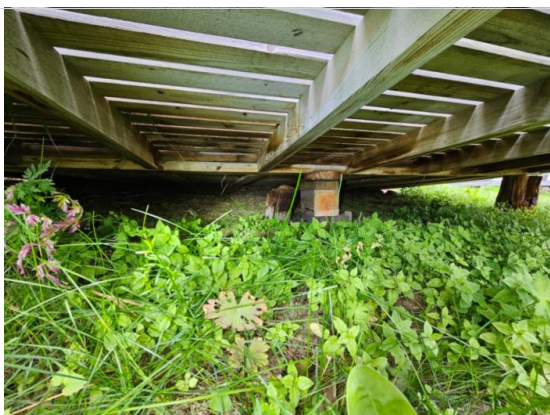
Bakkant på hytter er i kontakt med bakken, svak fundamentering som er kilt og rettet i ettertid.
