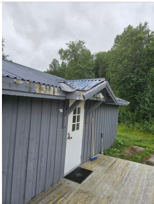
Bulker på takplater, mangler beslag over vindskier.
