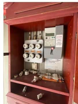
sikringsskap med skrusikringer.
