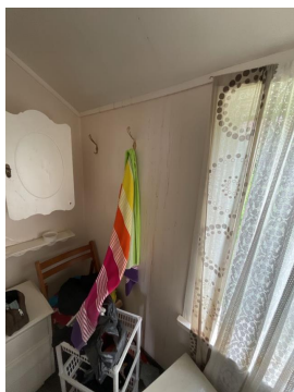
fuktflekker på vegg og himling i vaskerom 1 etasje.
