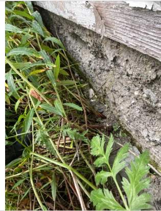
Grunnmur går i oppløsning
