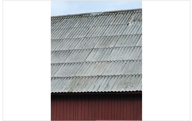
Mangler flere steder tetting i mønet.
