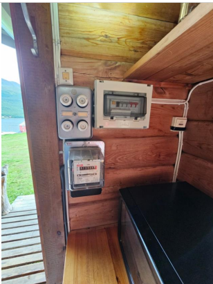
Skrusikringer, automatsikringer og måler på vegg.
