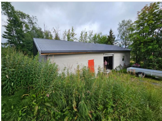
Bøy og sig på takrenne, takrenne mangler nedløp.
