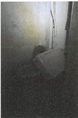
Defekt toalett i kjeller.
