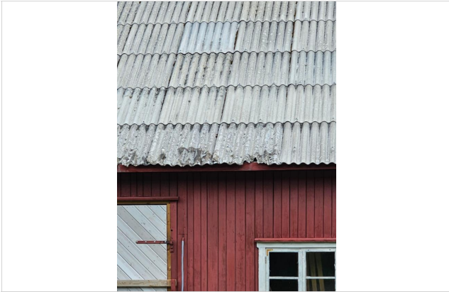
Skader på eternittplater, plater begynt og gå i oppløsning.
