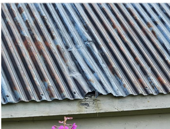
Bulker, skader og rust på taktekke.
