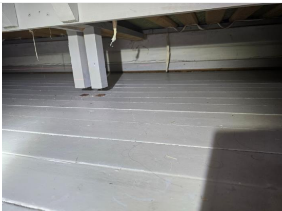
Gulv har seget flere cm, slik at køyeseng har ingen bæring på midten.
