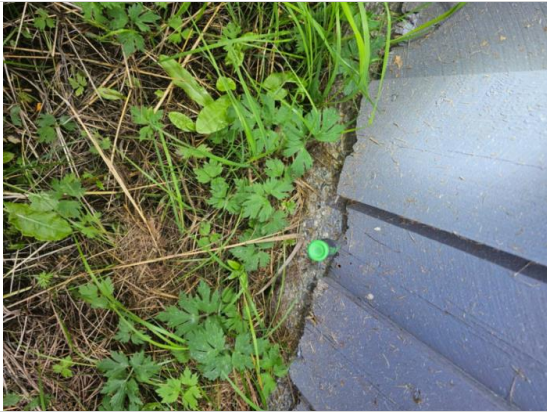
Råte på endeved på panel som er nært bakken.
