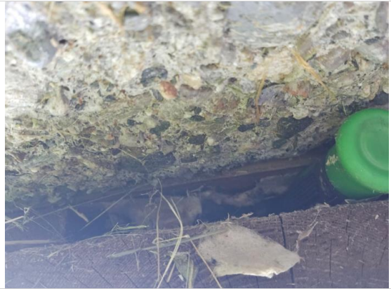
Mangler musestoppere på utvendig panel
