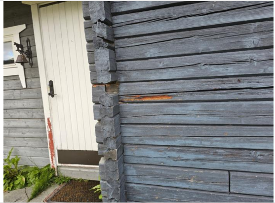
Synlig råte på tømmer
