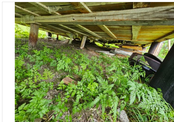
Utett stubb nr. 16 ser rett inn på isolasjon under bad og soverom
