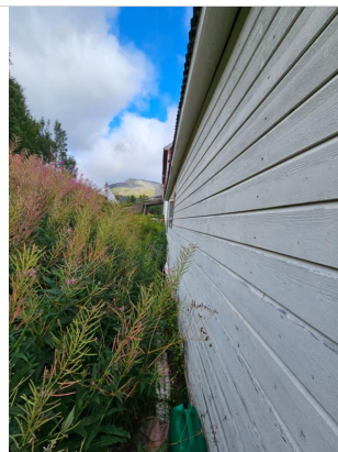
Treverk nært bakken, fall mot vegg, råteskader og fukt på vegg, synlige skjevheter på takkonstruksjon.
