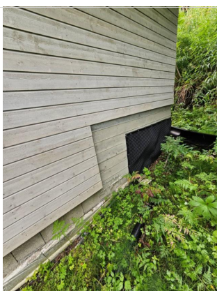
Kommer inn vann og fukt i bakkant for det om det er etablert drens. Murblokker under yttervegger er ikke forankret til betongunderlag.
