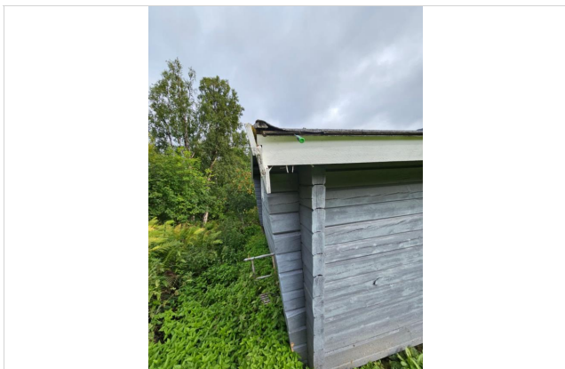
Råte på undertak nr. 16, mangler vannbord
