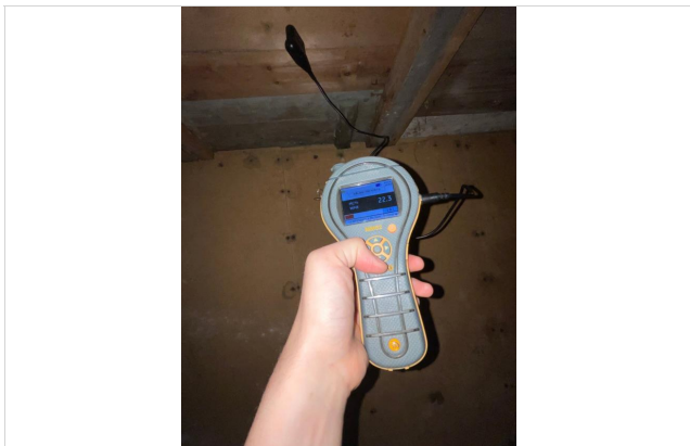
Fuktmåling i kjeller viser 22,3 prosent som gir grunnlag for vekst av muggsopp.
