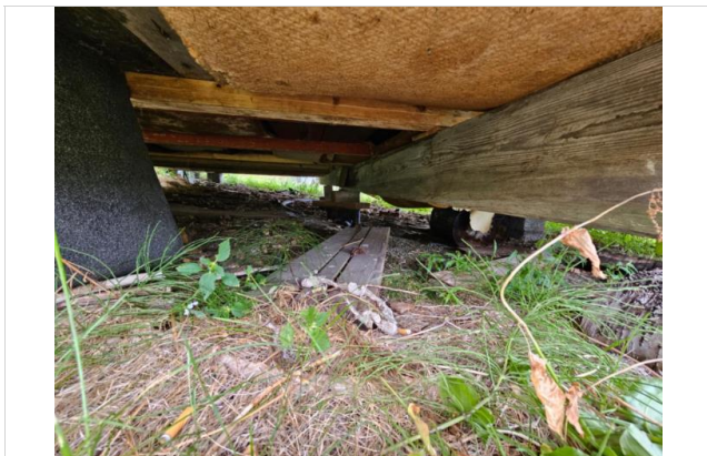
Svak fundamentering, mangelfull forankring av hytte til fundament.
