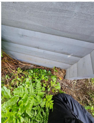
Treverk på baksiden av hytter er i kontakt med bakken og har symptomer på råteskader.
