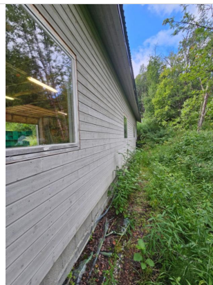
Ikke gjort ferdig med lister og brett rundt vinduer, dører og hjørner, det er ikke markisolert utvendig.
