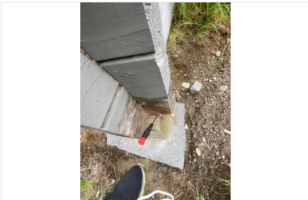
Råte i stokker på bakside som er nært bakken
