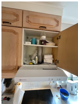
kjøkken ventilator med avtrekk ut.
