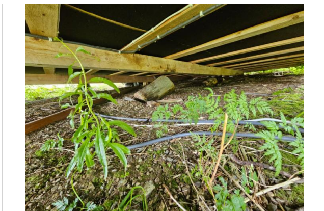
Fundamenter har ingen bærende funksjon under hytte nr. 17
