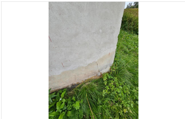
Sprekker på utvendig grunnmur ved hjørner og nedside.
