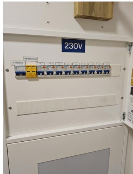
Elektrisk anlegg - [Sikringskap]
