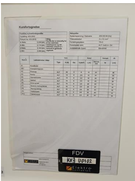
Elektrisk anlegg - [Kursfortegnelse sikringskap]
