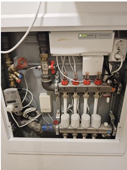
Vannbåren varme - [Fordelerskap for vannbåren varme]
