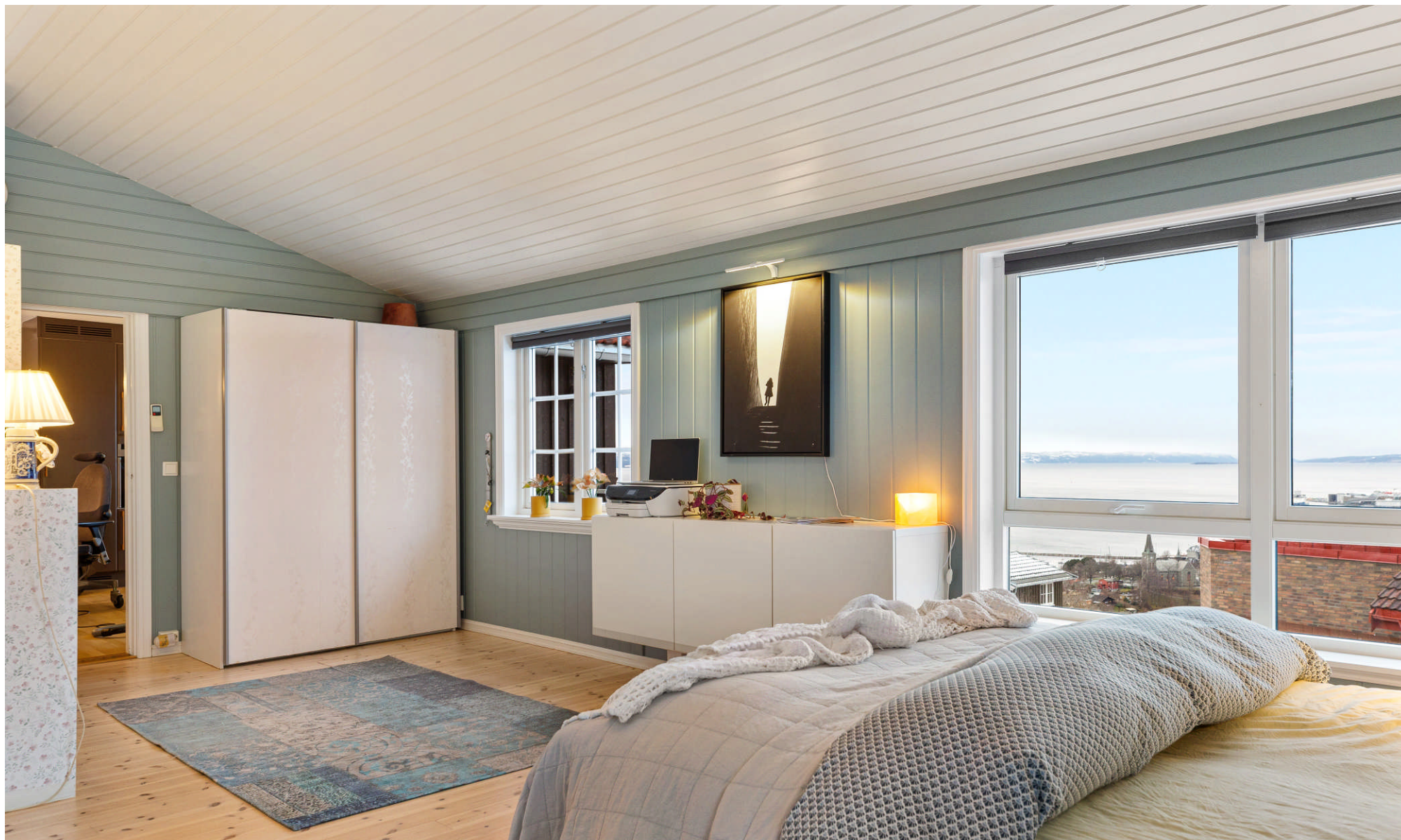
Det er installert balansert ventilasjon som sørger for godt inneklima i boligen.
