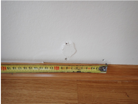
Eksempel på skade i vegg (stue)
