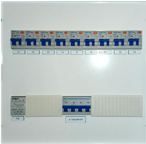
Forenklet vurdering av det elektriske anlegget - [Sikringskap]
