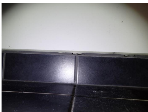
Eksempel på oppsprekking av flislim mellom bunnlist og sokkelflis
