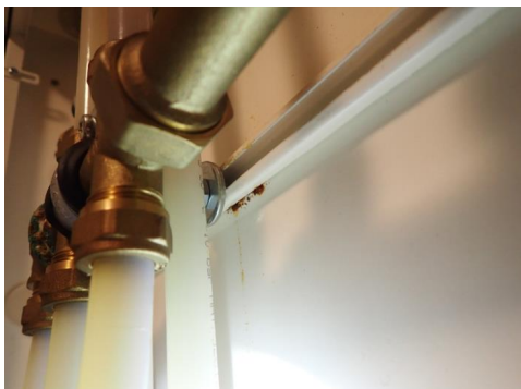
Mindre rustmerke på bakvegg
