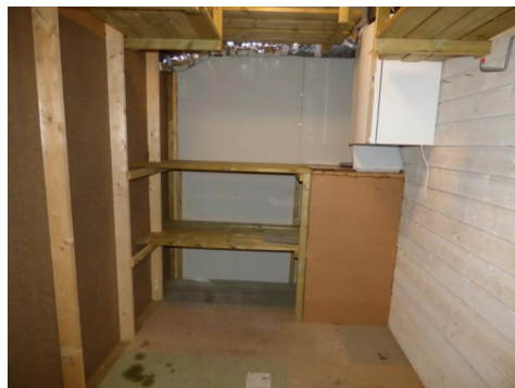
Fra utebod, VV-bereder i kasse til høyre
