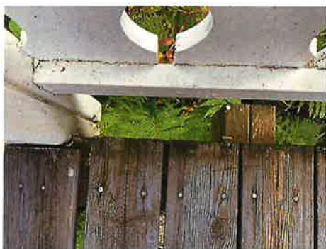
Råteskader på planting og bjelker
