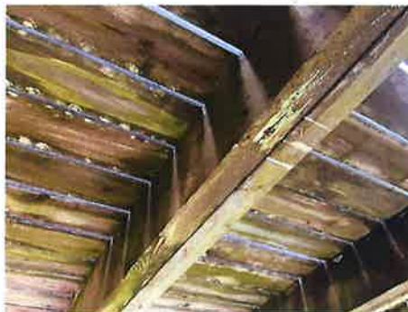
Lett råte- og algeangrep
