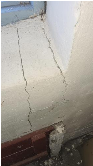
Frittstående byggverk - [Riss i fjøsvegg]
