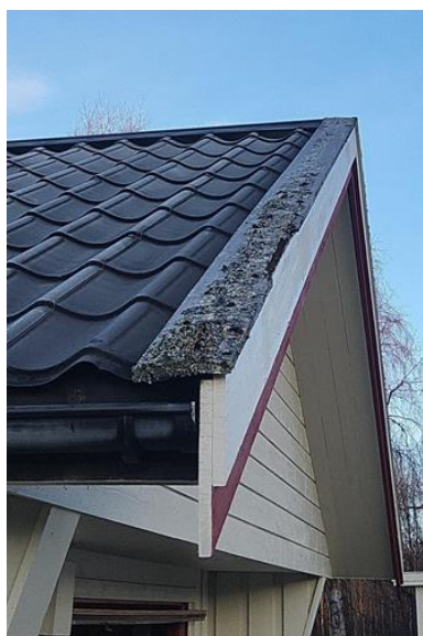
Frittstående byggverk - [Råteskade i vannbord på stor garasje]
