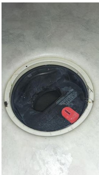
Avløpsrør (ink. sluk) - [Sluk bad Holmen 25]
