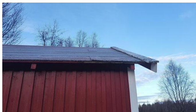
Frittstående byggverk - [Råteskader vannbord og taktro i liten garasje]
