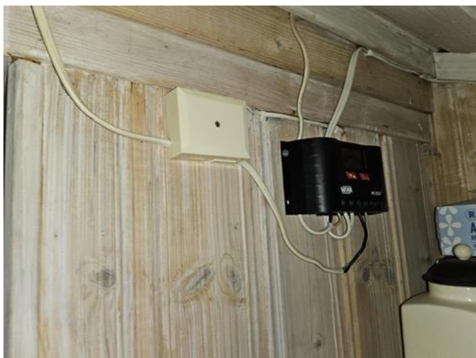
Elektrisk anlegg - [12-volts anlegg.]
