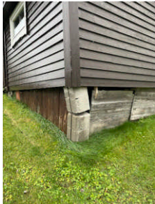
Store skjevheter i murer/pilarer. Annekset kan rase av pilarer om ikke mur/pilarer bygges opp på ny.
