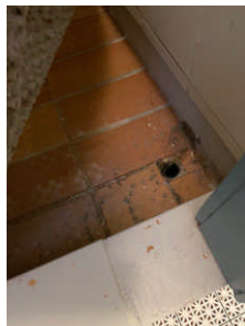
Sluk inne i dusjrom. Hull i gulv med utgang mot sluk i gulv inne i rommet.
