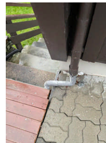
Avløpsrør for bortføring av takvann er underdimensjonert. Leder vann til terreng ved bolig.
