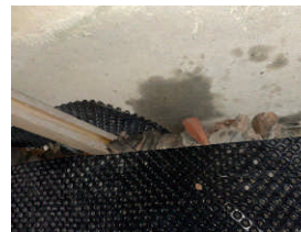
Synlig knottplast mot grunnmur under terrasse. Ingen topplst registrert.
