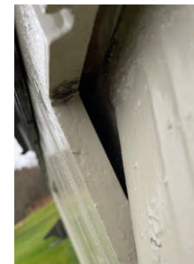
Det registreres lufting bak kledning på mur.
