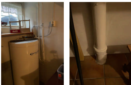
Avløpsrør av soil.
