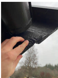
Råte/skader i vindski.
