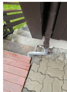
Ingen synlig grunnmursplast over terreng ved inngang til bolig.
