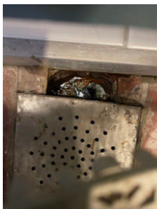
Sluk i gulv av eldre type.
