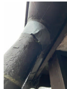
Det er hull i taknedløp/takrenner.
