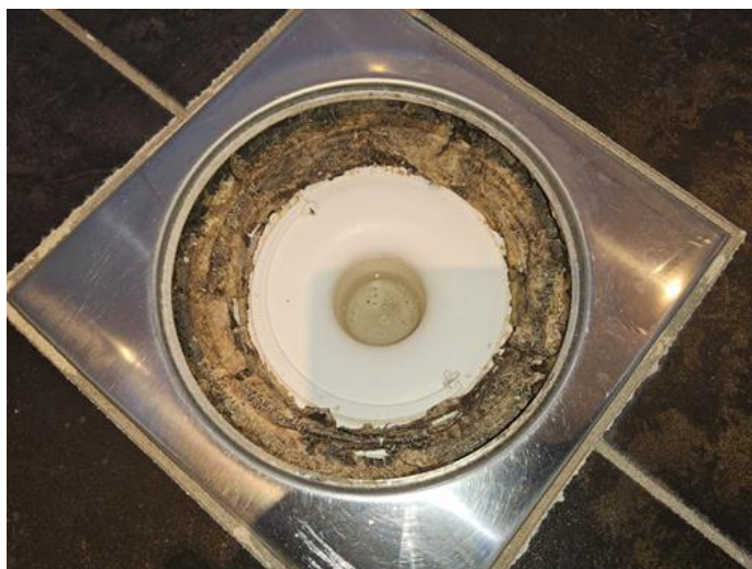
Våtrom - [Sluk bad 1.etg dusjsone. ]
