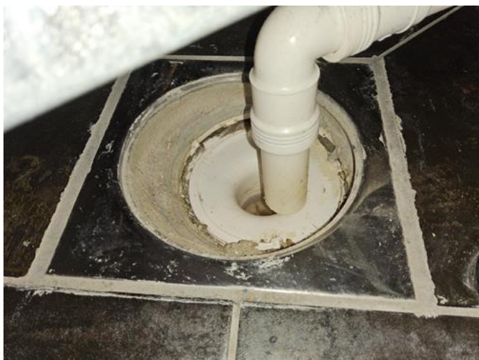
Våtrom - [Sluk bad 1.etg under badekar. ]
