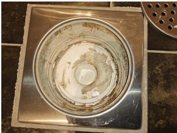
Våtrom - [Sluk bad 2.etg dusjsone.]
