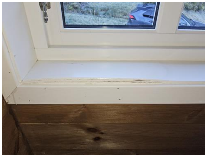
Dører og vinduer - [Fuktmerker i vinduskarm 2.etg. ]
