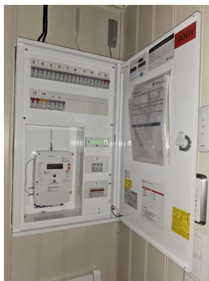
Elektrisk anlegg - [Sikringskap. ]
