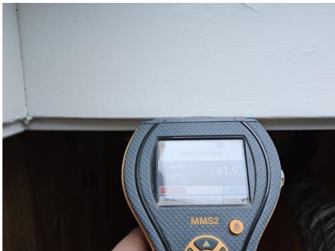
Dører og vinduer - [Fuktmåling vinduskarmen 2.etg. ]
