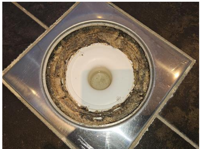
Våtrom - [Sluk bad 1.etg dusjsone. ]
