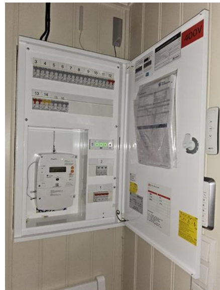
Elektrisk anlegg - [Sikringskap. ]
