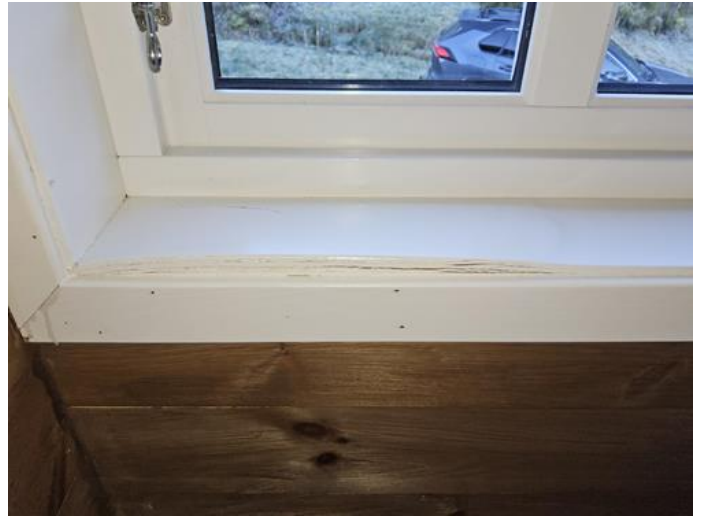
Dører og vinduer - [Fuktmerker i vinduskarm 2.etg. ]
