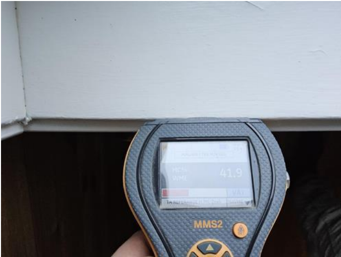
Dører og vinduer - [Fuktmåling vinduskarmen 2.etg. ]
