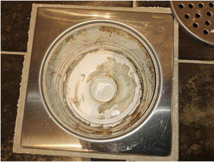
Våtrom - [Sluk bad 2.etg dusjsone.]
