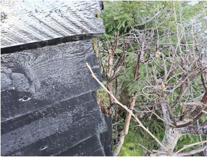
Terrasser / platting på terreng - [Råteskader på rekkverk terrasse.]
