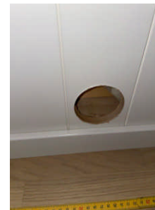
Hulltaking og fuktmåling er gjort under trapp, inn mot våtrommet.
