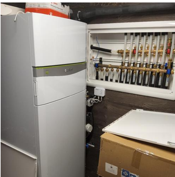
Tekniske anlegg, VVS anlegg (Sjekkpunkter utover det som er inkludert i andre rom) - [Fordelerskap for rør-i-rør system
