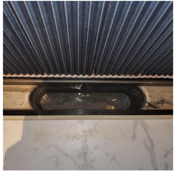
Avløpsrør (ink. sluk) - [Sluk bad 3]
