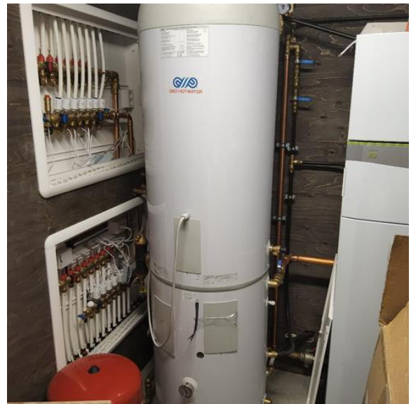
Tekniske anlegg, VVS anlegg (Sjekkpunkter utover det som er inkludert i andre rom) - [Fordelerskap for vannbåren varme og varmtvannsbereder]
