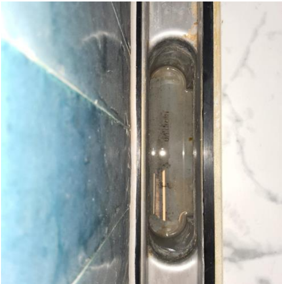
Avløpsrør (ink. sluk) - [Sluk bad 1]
