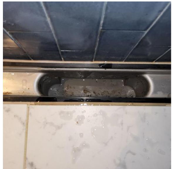
Avløpsrør (ink. sluk) - [Sluk bad 2]
