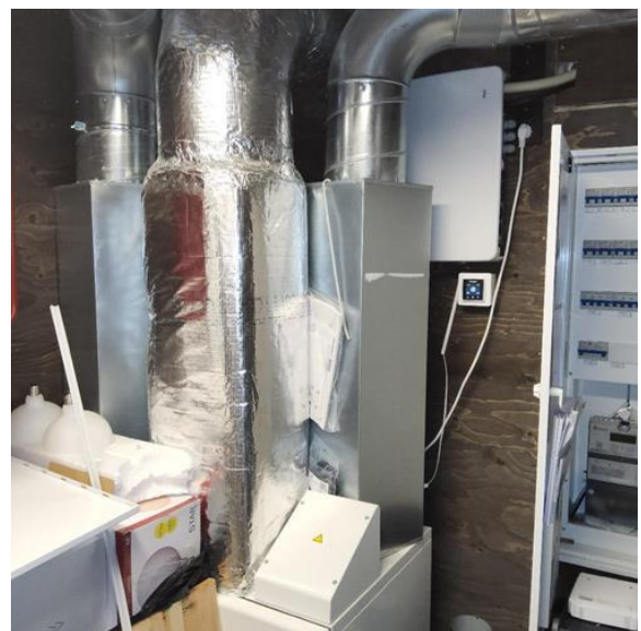
Tekniske anlegg, VVS anlegg (Sjekkpunkter utover det som er inkludert i andre rom) - [Ventilasjonsanlegg ]
