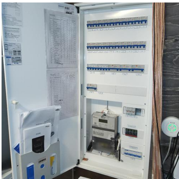
Elektrisk anlegg - [Sikringsskap og kursoversikt plassert på teknisk rom]
