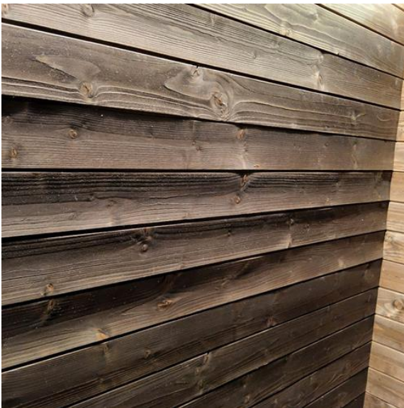
[Spesialrom (badstue, kjølerom, svømmebasseng etc). OBS! Bygningsfysikk.] - [Eksempel på kuing i materialer i badstue ]
