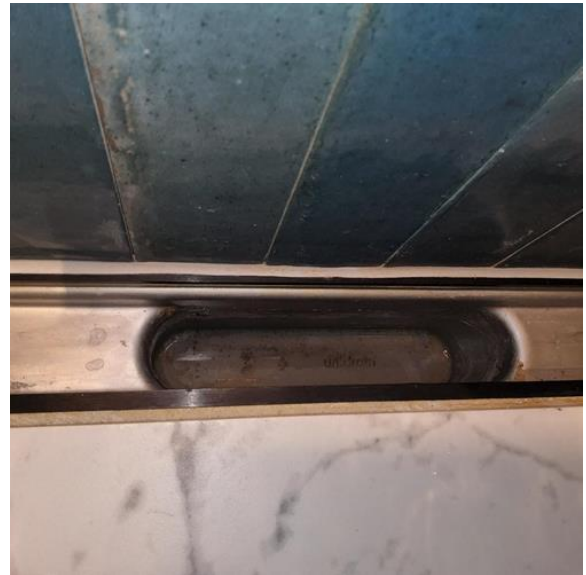
Avløpsrør (ink. sluk) - [Sluk bad 1]
