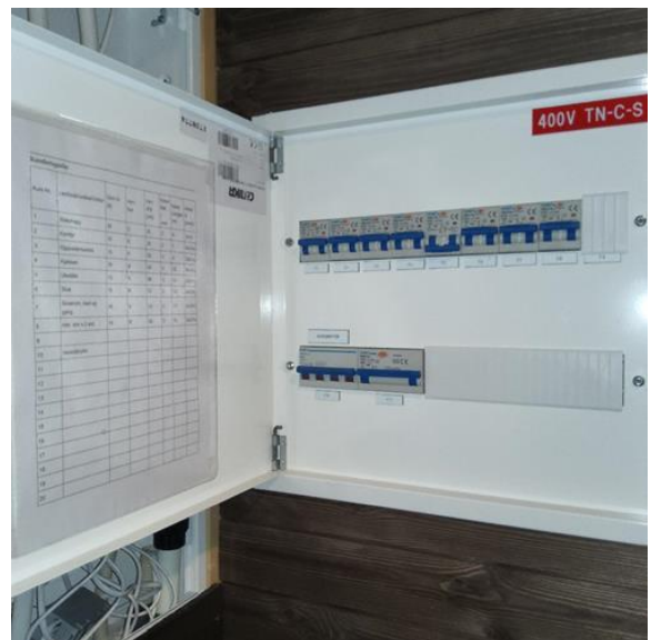
Elektrisk anlegg - [Sikringskap og kursoversikt plassert i bod 4]
