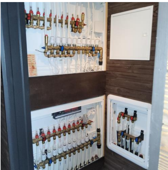
Tekniske anlegg, VVS anlegg (Sjekkpunkter utover det som er inkludert i andre rom) - [Fordelerskap for rør-i-rør system og vannbåren varme plassert i bod 4]
