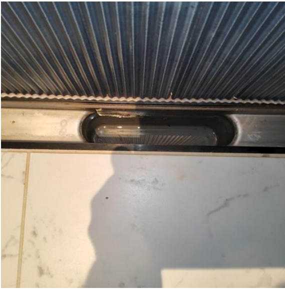
Avløpsrør (ink. sluk) - [Sluk bad 4]
