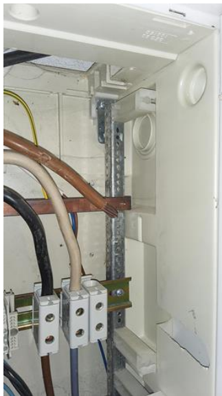
Forenklet vurdering av det elektriske anlegget - [Åpninger i skap og berøringsfare]
