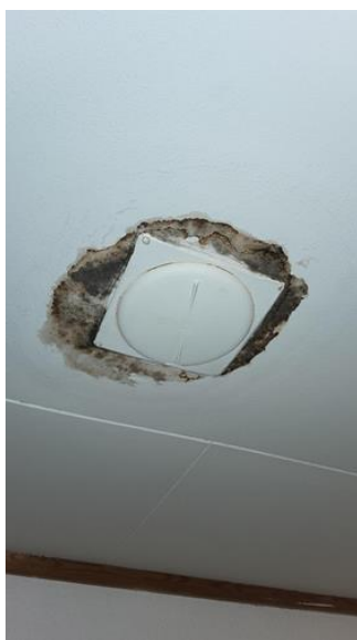
Helhetsvurdering - [Fuktskade rundt ventil vaskerom]
