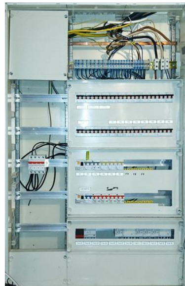
Forenklet vurdering av det elektriske anlegget - [Sikringskap kjeller]
