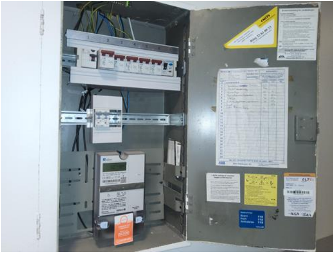
Beskrivelse - [Sikringskap med kursfortegnelse.]
