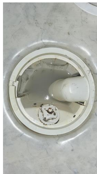
Avløpsrør (ink. sluk) - [Sluk vaskerom]
