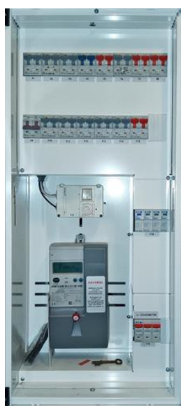
Forenklet vurdering av det elektriske anlegget - [Sikringsskap]
