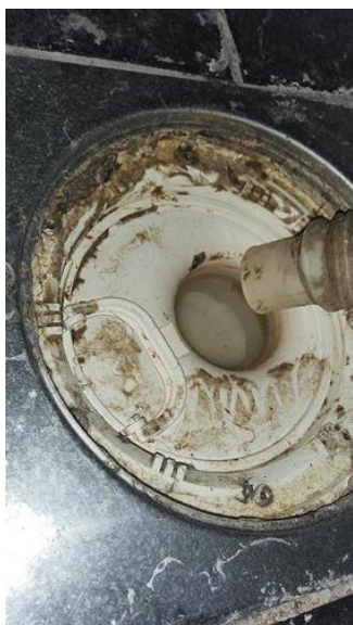
Avløpsrør (ink. sluk) - [Sluk bad]
