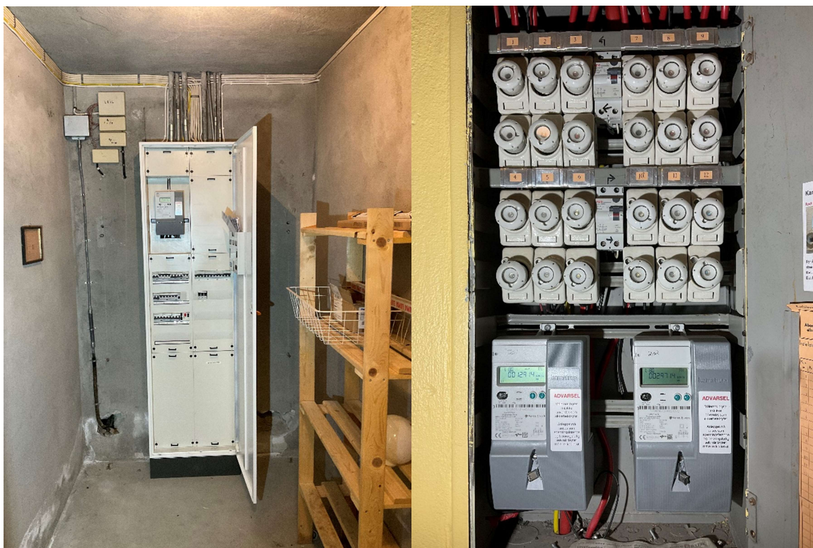
Hovedtavle med måler i underetasjen.
