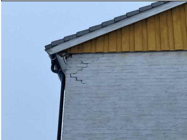
Sprekk i murfasade.
