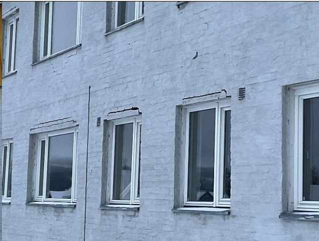
Sprekkdannelse over vinduer.
