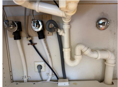
Røropplegg og aquastop under vask.
