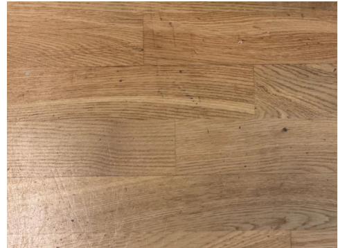
Slitasje/striper i parkett i kjøkkendel.
