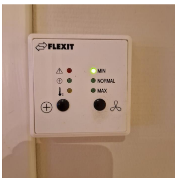
Styringspanel for ventilasjon.
