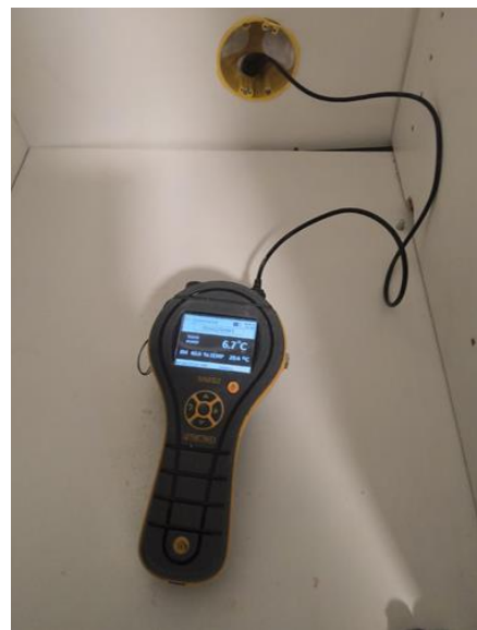
Fukt i tilliggende konstruksjoner - [Fuktmåling]
