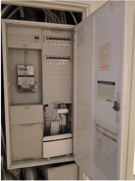
Elektrisk anlegg - [Sikringskap ]
