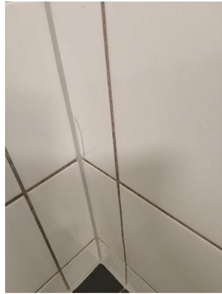
Overflater vegger - [Sprukket flis i dusjsonen]
