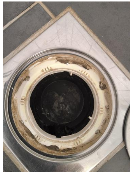
Slukets plassering i forhold til at vann utenfor dusjsonen kan nå det - [Sluk i dusjsonen]
