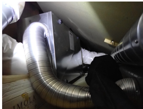
Ventilasjonsanlegg i kott
