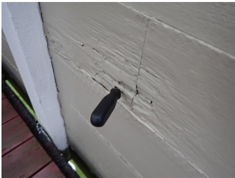
Råte i deler av rekkverk
