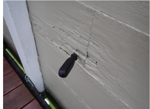
Råte i deler av rekkverk
