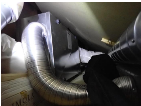
Ventilasjonsanlegg i kott
