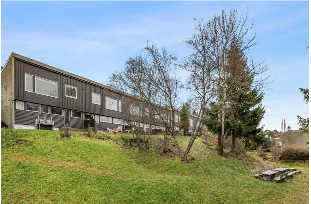
Det er drenert rundt bygget i 2015, det er skiftet vinduer, kledning, vindspærre og etterisolert i 2013.
