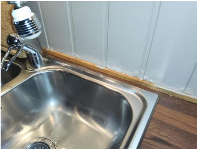
Overflater vegger - [Svelleskader på vegg ved oppvaskkum på kjøkken. ]
