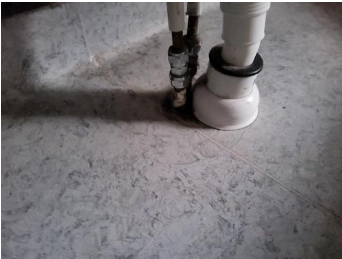
Membran, tettesjikt og overgang til sluk. - [Eksempel på rørgjennomføringer i gulv på bad. ]
