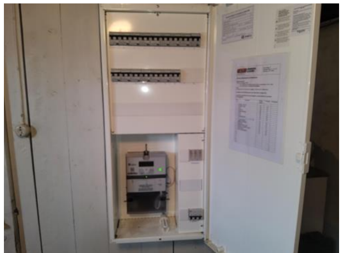
Elektrisk anlegg - [Sikringskap kjeller. ]
