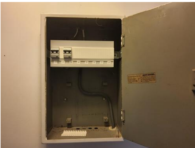
Elektrisk anlegg - [Sikringskap 2.etasje. ]
