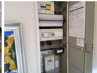
Elektrisk anlegg - [Sikringskap.]
