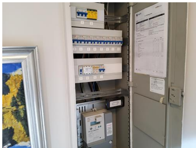
Elektrisk anlegg - [Sikringskap. ]
