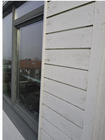
Yttervegger inkl. fasader og konstruksjon - [Råteskader ved vindu]
