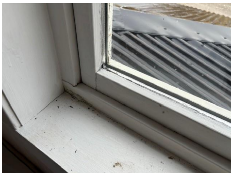
Slitasje på eldre vindu
