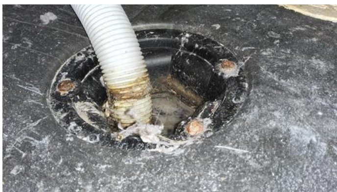
Avløpsrør (ink. sluk) - [Sluk bad 1. etasje]
