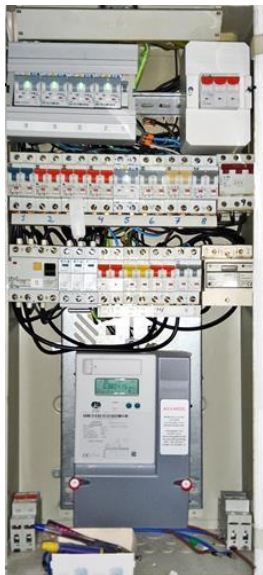
Forenklet vurdering av det elektriske anlegget - [Sikringskap]
