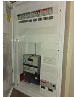
Elektrisk anlegg - [Sikringskap]
