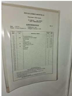
Elektrisk anlegg - [Kursfortegnelse sikringskap]
