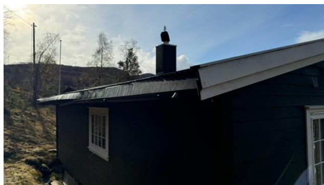
Bilde viser at det mangler takrenne på baksiden.
