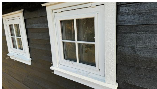
Bilde viser vindu med noe slitasje og behov overflatebehandling.
