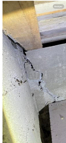
Grunnmur - [Sprekker grunnmur]
