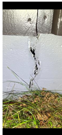
Grunnmur - [Sprekker grunnmur]
