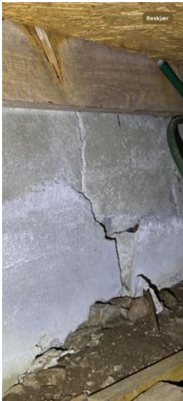
Grunnmur - [Sprekker grunnmur]
