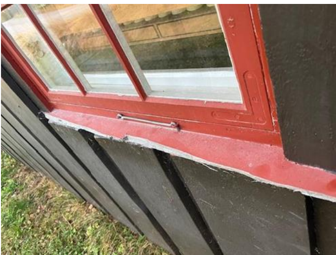
Vinduer - [Ødelagt vannbrett]
