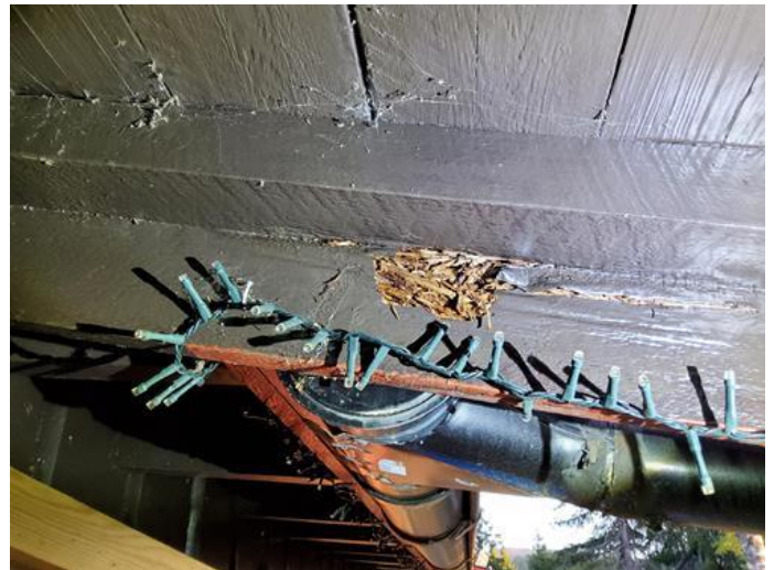
Yttervegger inkl. fasader og konstruksjon - [Eksempel på råteskader]
