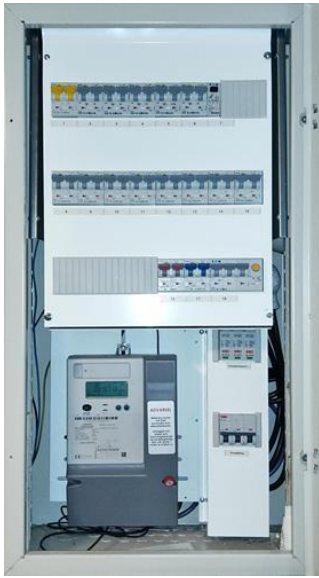
Forenklet vurdering av det elektriske anlegget - [Sikringskapp]
