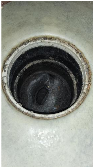
Avløpsrør (ink. sluk) - [Sluk vaskerom]
