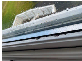
Det registreres fukt i treverk på innside av glass.
