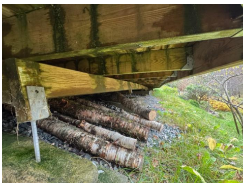
Sig/skjevheter i ytre del av terrasse.
