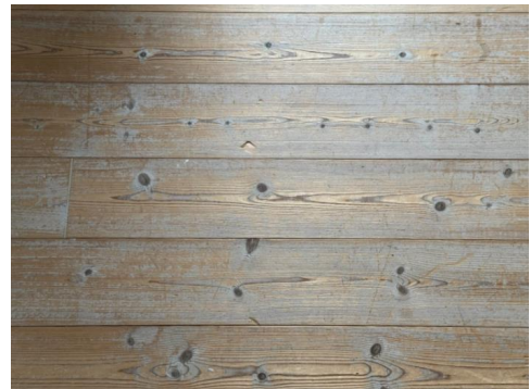
Slitasje/striper i furugulv på soverom i u-etg.
