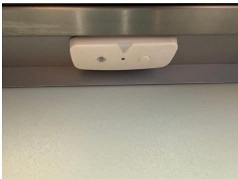
Komfyrvakt v/ kjøkkenventilator.
