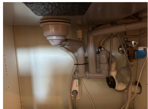
Rørøpplagg og aquastop under vask.
