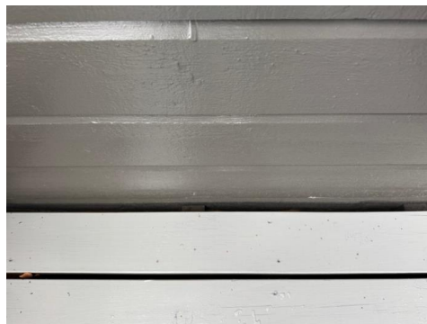
Ingen beslag i overgang kledningsbord - terrassebord.
