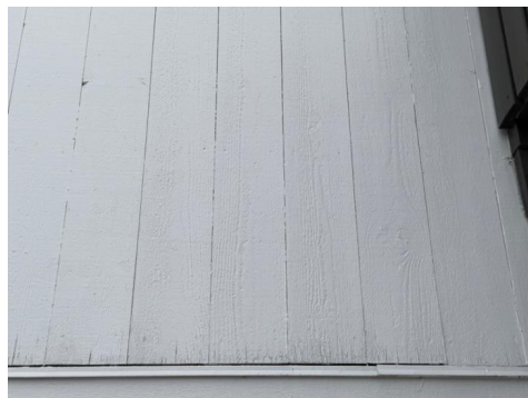
Slitasje i nedre del av stående kledning.
