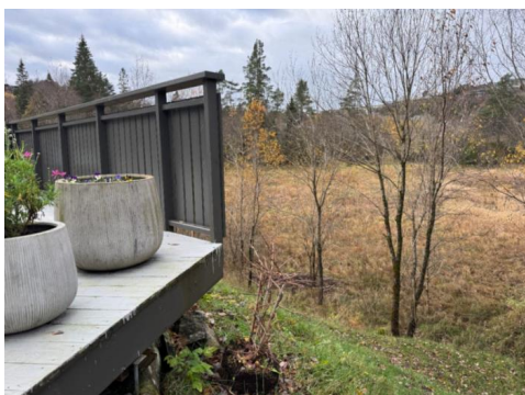
Det bør monteres rekkverk på siden hvor nivåforskjell er over 0,50 m.
