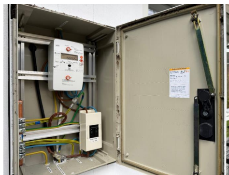
Utvendig målerskap v/ inngangsparti.
