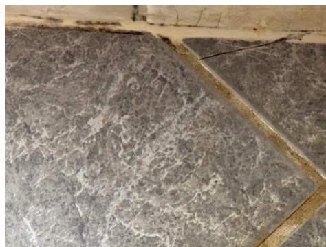
Sprekk i gulvflis i dusjsone.
