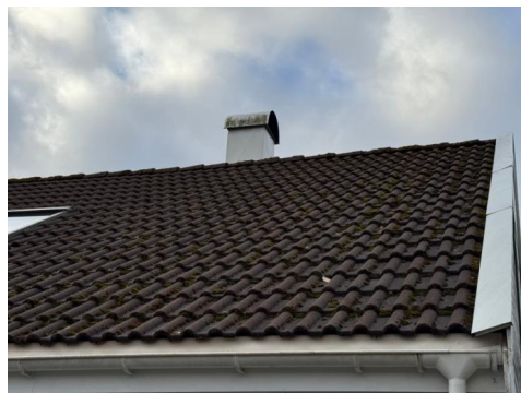
Taktekking er mosegrodd flere steder. Mose bør fjernes.
