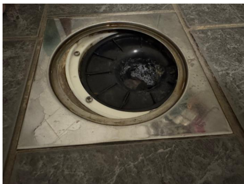
Plastsluk i dusjsone.
