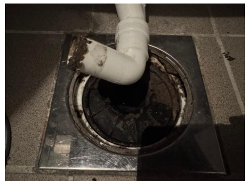
Plastsluk i gulv.
