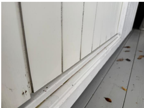
Fuktutsvelling i nedre del av terrassedør på soverom.
