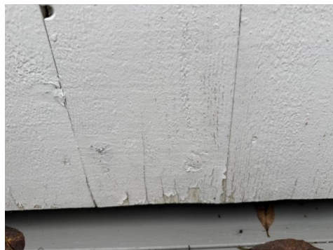
Slitasje i nedre del av stående kledning.
