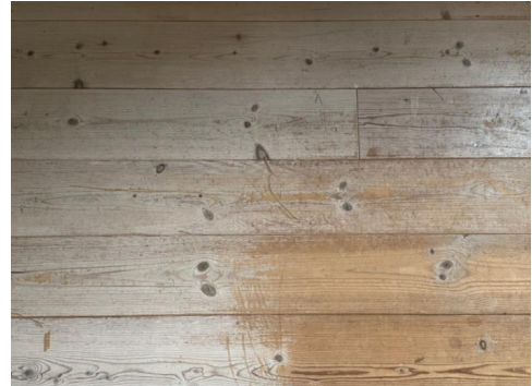
Slitasje/striper i furugulv på soverom i u-etg.
