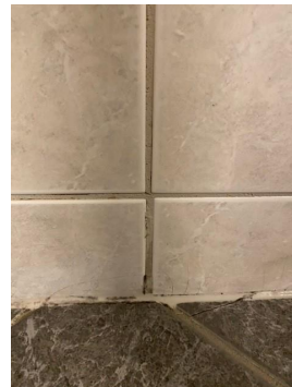
Riss/sprekker i veggflis i dusjsone.
