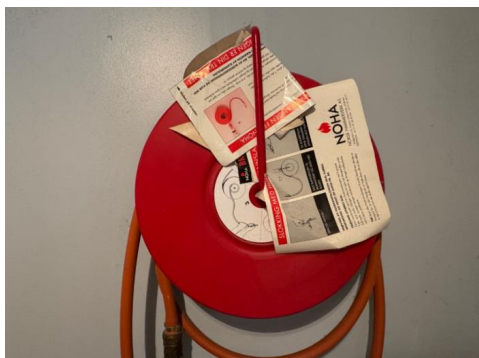
Brannslange på vaskerom.
