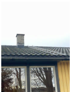
Bilde av pipe over tak. Mangler heldekkende beslag.
