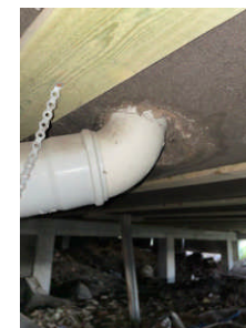
Fuktskader i stubbloftsplater registreres.
