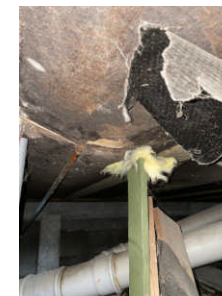
Fuktskader i stubbloftsplater registreres.
