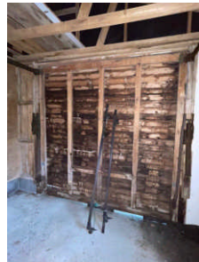
Port i treverk, fuktskadet.
