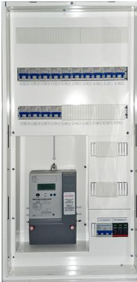
Forenklet vurdering av det elektriske anlegget - [Sikringsskap]
