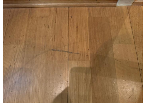
Slitasje/striper i parkettgulv.
