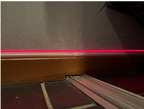
Bilder viser skjevheter i gulv i entre.
