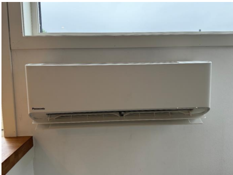
Varmepumpe med uttak i trapperom.
