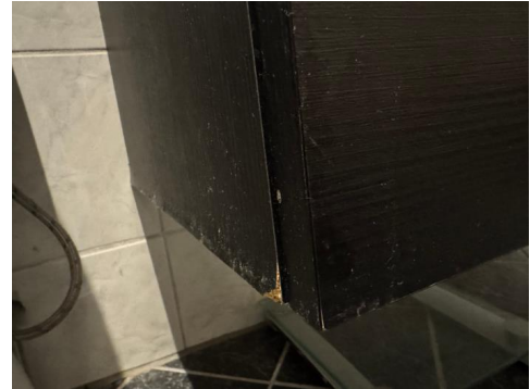
Fuktutsvelling i nedre del av baderomsinnredning.
