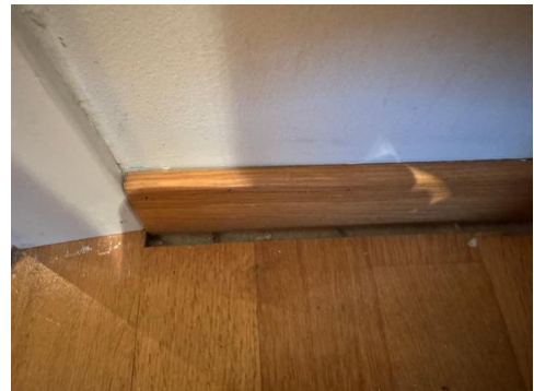
Glip mellom gulvlist-parkett på det ene soverommet i 1-etg.
