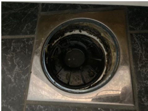
Plastsluk i dusjsone.
