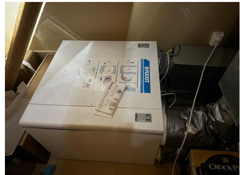
Luftbehandlingsaggregat på koffertloft.
