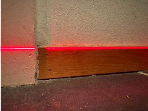
Bilder viser skjevheter i gulv i entre.
