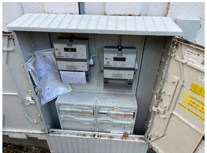
Elektrisk anlegg - [Sikringskap utvendig]
