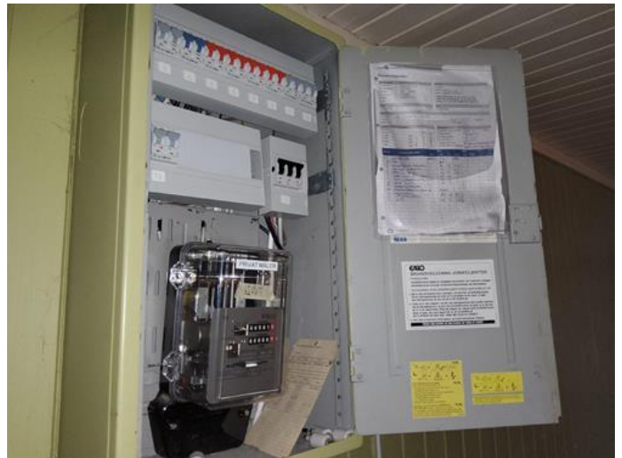
Elektrisk anlegg - [Sikringskap]
