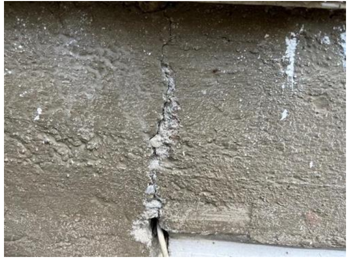
Grunnmur - [Eksempel på sprekker i grunnmur]
