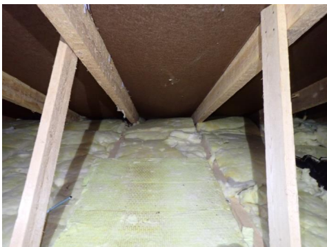
Dårlig/ingen lufting langs raft
