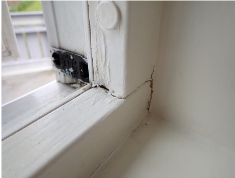
Fukt/kondensmerker, vindu på kjøkken
