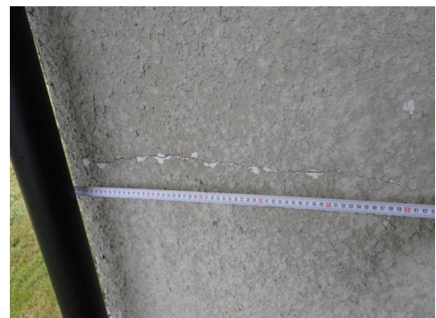
Sprekk ved hjørne mot sør/sørøst
