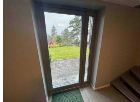
Ytterdør med luftlekkasje og defekt håndtak.
