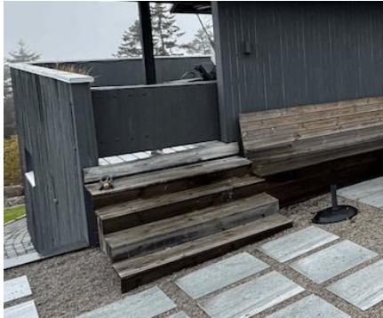
Trapp mangler rekkverk
