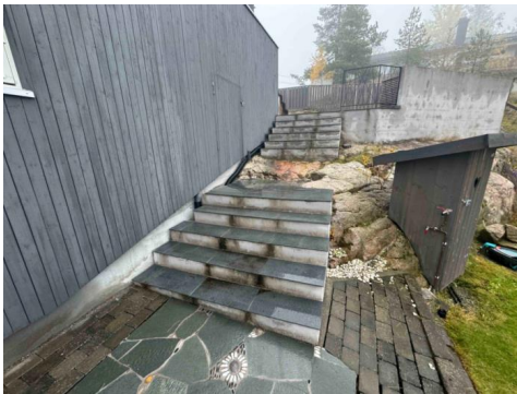
Trapp mangler rekkverk og har skade i flis
