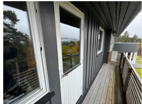
Verandadør med skader.
