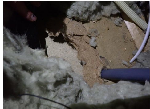
Ingen synlig diffusjonssperre
