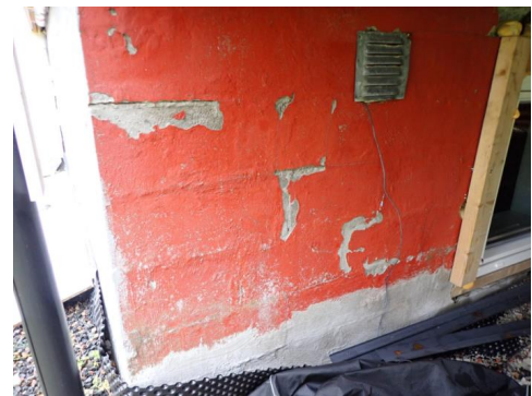
Eksempel på oppsprekking
