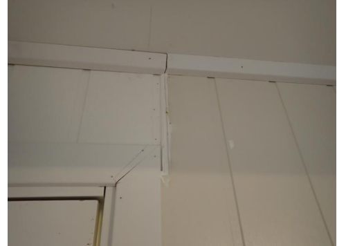
Eksempel på mindre avvik (stue ved kjellernedgang)
