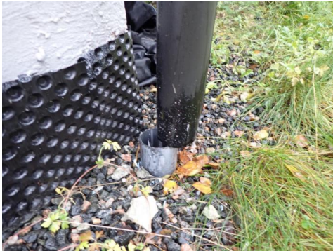
Taknedløp treffer ikke rør i bakken
