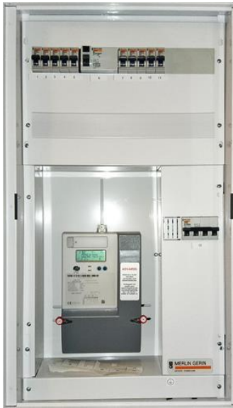
Forenklet vurdering av det elektriske anlegget - [Sikringskap]
