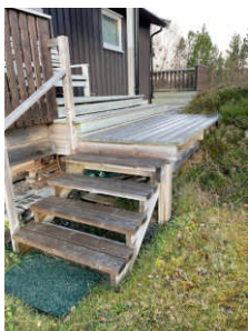
Det anbefales å etablere rekkverk på platt/balkong/trapp hvor avstand til bakkenivå er over 50cm.
