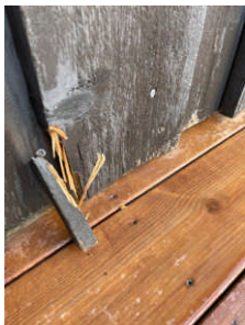
Råte i kledning.
