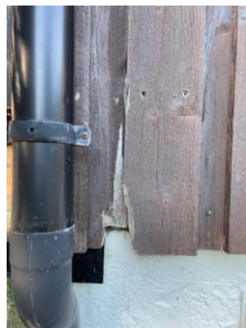
Råte og slitt kledning.
