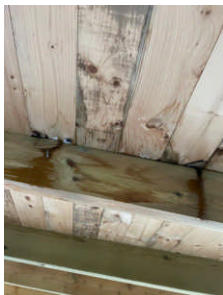
Lekkasje fra tak i bod/garasje.
