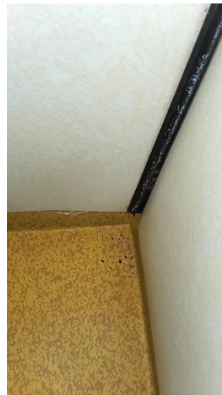
Kommentar - [Skadet baderomsplate i dusj]
