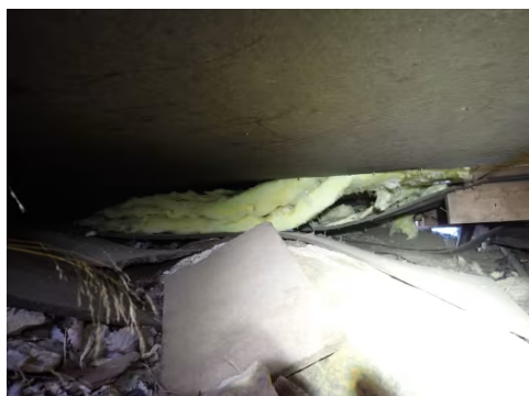
Under tilbygget soverom har stubbloftsplater løsnet og isolasjon har falt ut av konstruksjonen.
