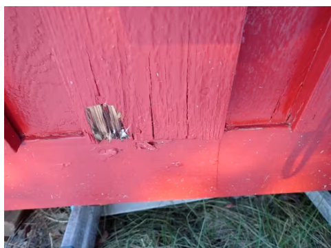
Kledning med råte.
