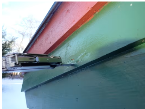
Råte i vindskier.
