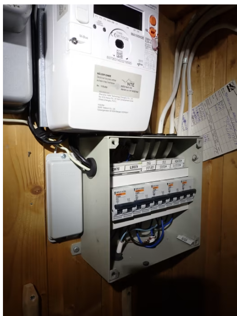
Sikringsskap i vindfang.
