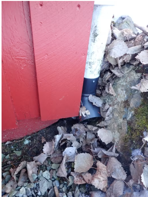
Utkast på nedløp ved vegg, stor fuktpåkjenning mot fundament.
