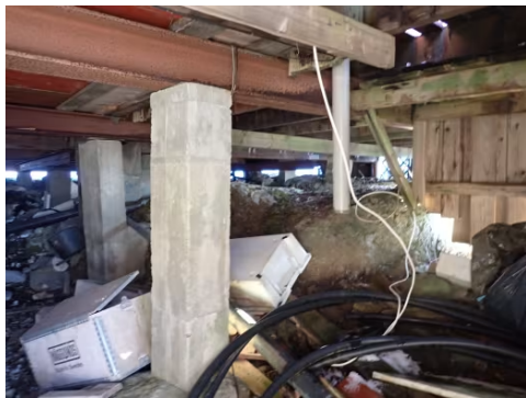
Pilarer/fundament med skjevheter.
