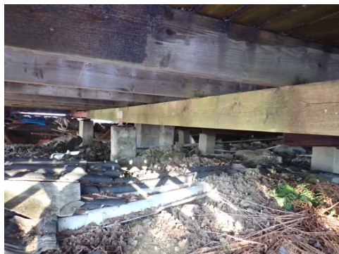
Manglende understøttelse under bærende drager.
