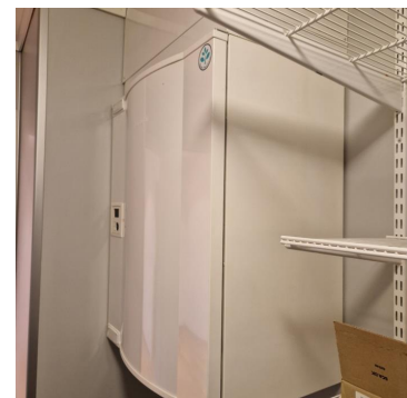
Aggregat plassert på vaskerom
